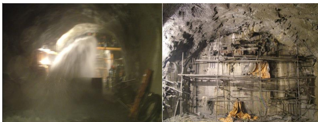
西南地区某隧道突涌水抢险
