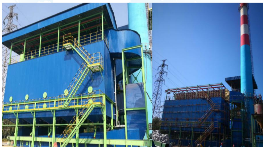
图 40 唐山荣程特钢动力厂 15MW 高炉煤气发电锅炉脱硫处理项目
